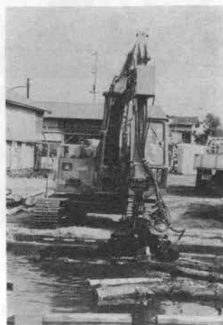
写真-6 試験用流木処理装置
