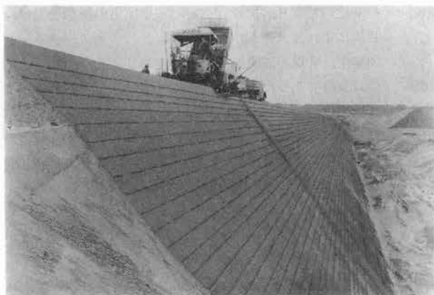
写真—1 アスファルトフィニッシャによる堤体の施工 (西独フェーゲル社提供)
