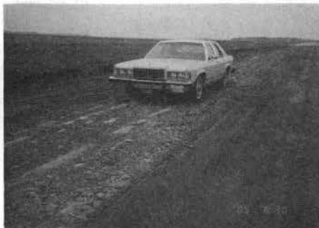
写真-2 破砕した後のコンクリート舗装道路 (右側車線部は未破砕)
