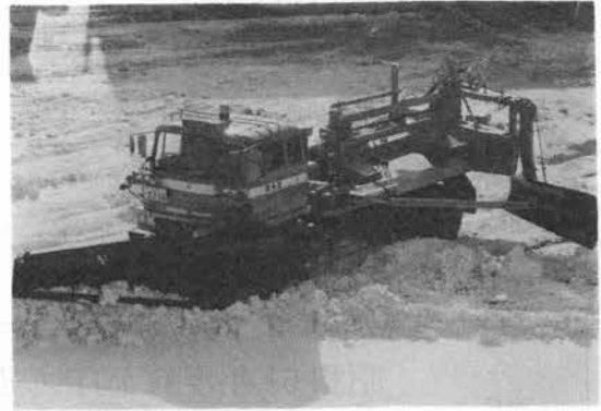
写真-10 サイドウイング、マックレ切換装置
