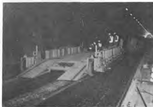
写真-26 トラックターンテーブル
