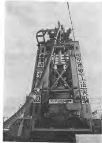
写真-9 超壁厚大深度地中連続壁掘削装置
