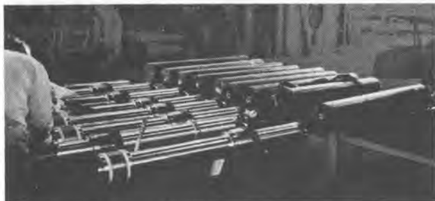
▲シールドジャッキの整備工場
