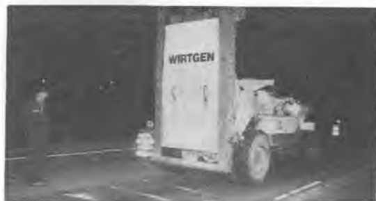
写真-2 Wirtgen, CB-7000 による旧コンクリート舗装路のクラッキング
