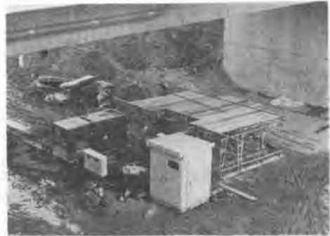
写真-1 高圧グラウトプラント
