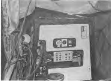
写真-2 高圧発生装置
