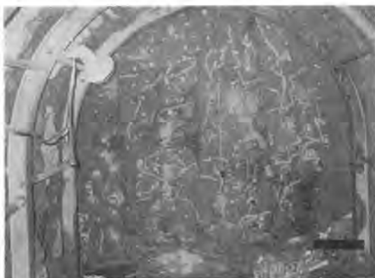
写真-8 クラックの発生状況 (パターン II)
