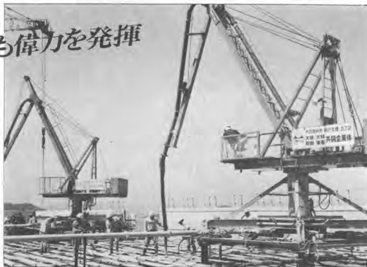
(本四架橋現場設置例)
