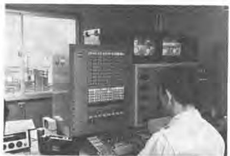
写真-3 レベルモニタ盤によるレベル制御
