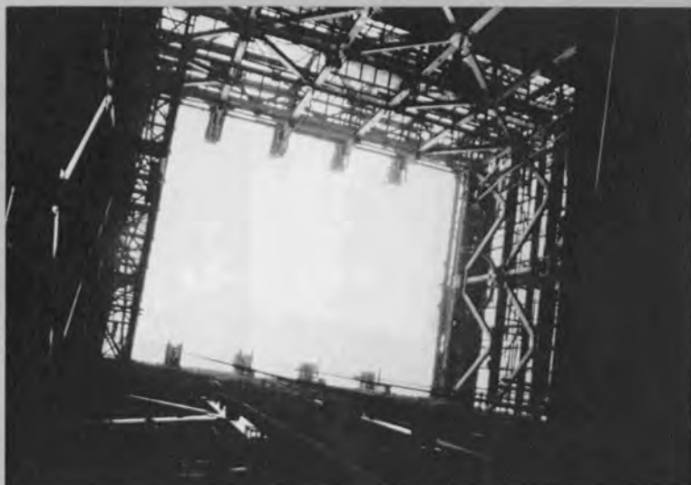
◆ボイラー棟内部，下から上を見上げる
