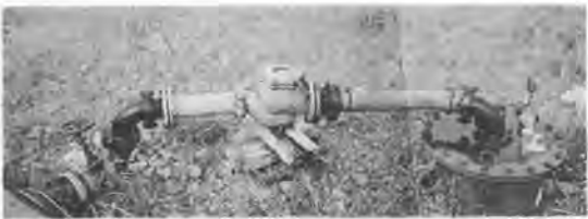
写真-3 注水井の頭部
