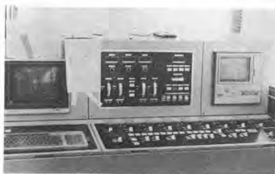
左：配合設定表示（設定画面） 中：ホットビン各材料の残量表示（運転画面） 右：各材料の温度表示（同上）
