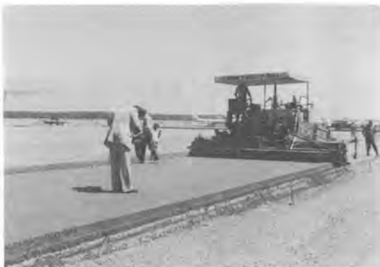
写真-3 転圧コンクリート舗装を敷ならしているアスファルトフィニッシャ（西独 ABG 社製）
