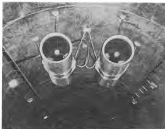
写真一1 ジェットファンのトンネル内設置
