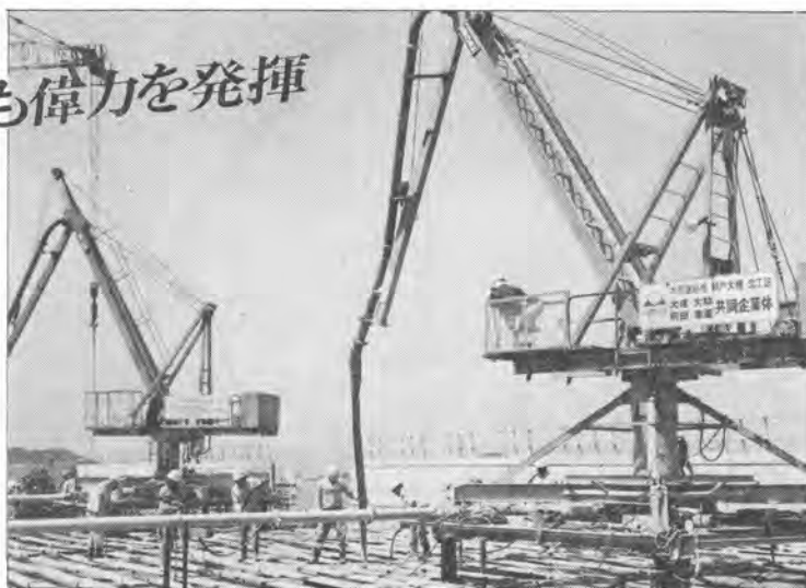
(本四架橋現場設置例)
