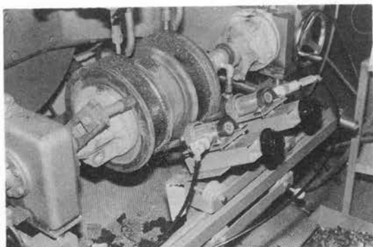
写真-2 スラグ自動除去装置
