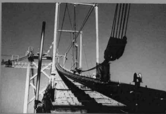
⇨キャットウォーク上でのケーブルストランドの架設作業
