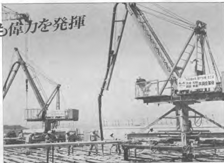
(本四架橋現場設置例)
