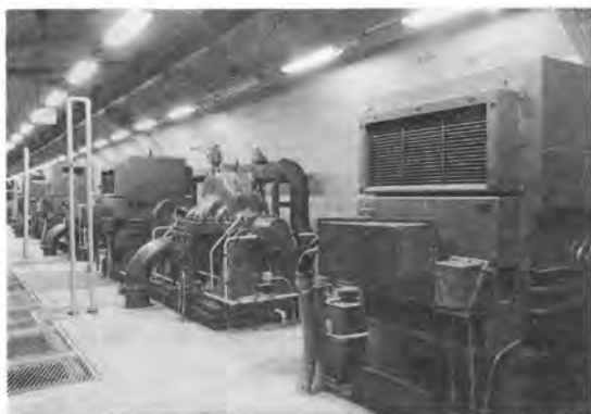
写真—9 高揚程多段渦巻ポンプ
