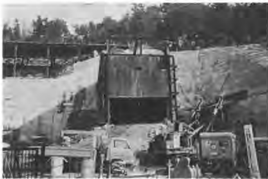
写真-3 坑口に設けた防音塙
