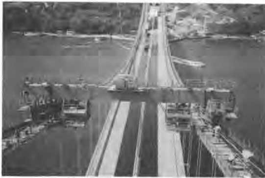
写真-3 L/B 上部設備の全景
