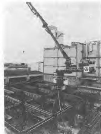
写真-6 自動制御式プレーシングクレーン (クレーン仕様)
