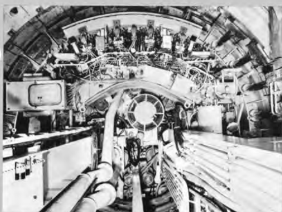
◆シールド工用セグメント自動組立ロボット（熊谷組） セグメント自動供給装置からセグメントを受取り、あらかじめ決められた位置（写真では上部）にセットし、自動的に組付ける
