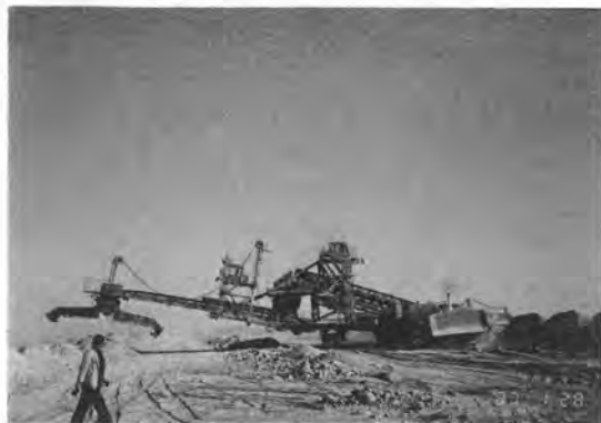
写真-4 三菱重工コンベヤローダ
