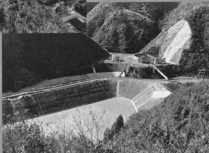
沈砂池, 濁水処理プラント⇨
