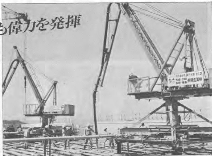
(本四架橋現場設置例)
