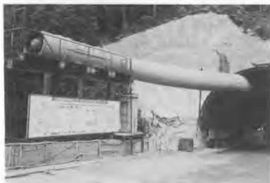
写真-28 コントラファン
