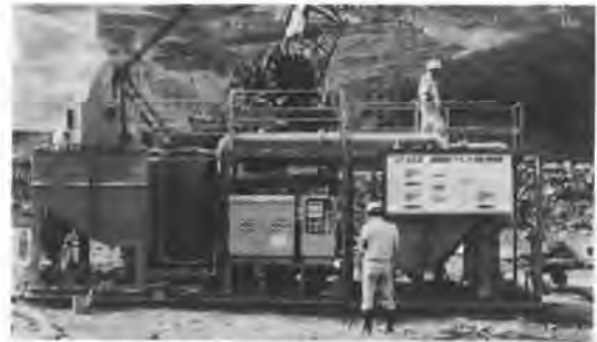
写真一 連続混合プラント (連続混合方式)
