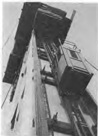
写真-3 昇降用エレベータと曲線レール
