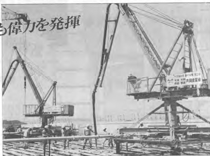
(本四架橋現場設置例)
