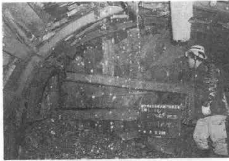
写真一 仏像構造線 (1,809 m 付近) 崩壊状況
