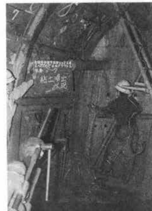
写真-3 ボーリング孔よりの粘土噴出状況 (2,556 m 地点)
