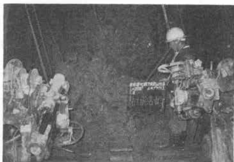
写真—4 粘土崩落状況 (2,556 m 地点)
