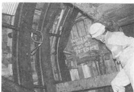
写真—5 支保工変形の状況 (2,664.3 m 地点)
