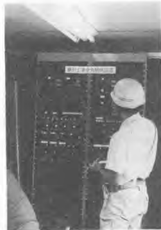
写真-6 指令室内の操作盤、変位計等の中央制御装置
