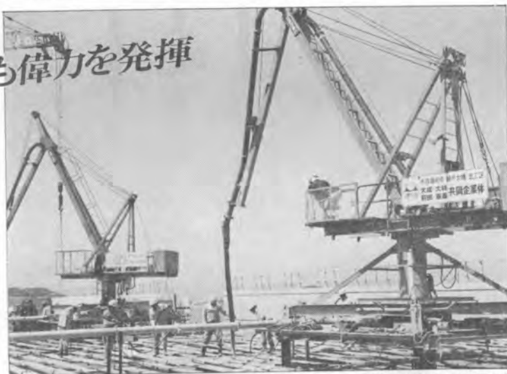
(本四架橋現場設置例)
