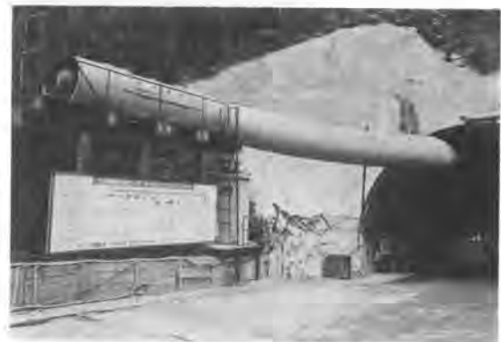
写真-1 登俣トンネルにおける動翼可変ピッチ型 コントラファン設置例
