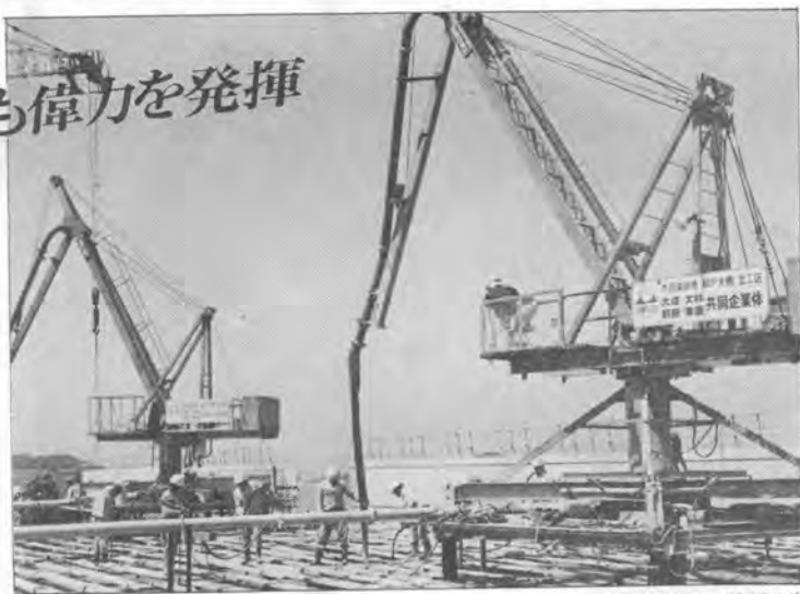
(本四架橋現場設置例)
