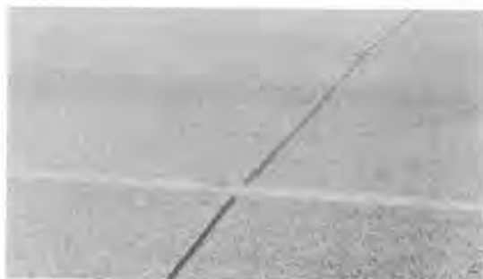
写真-1 アスファルトオーバーレイ上に無処置の場合に発生するクラッキング
