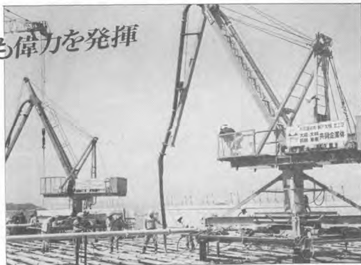
(本四架橋現場設置例)
