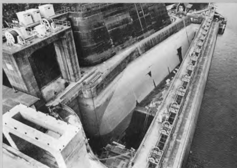
取水口前庭部排水状況⇨
