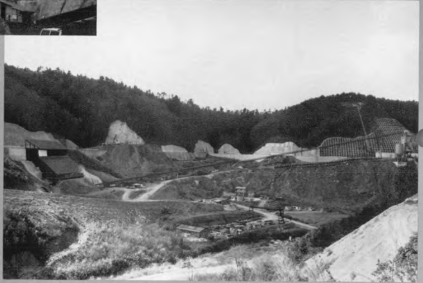
⇨ 骨材輸送設備
