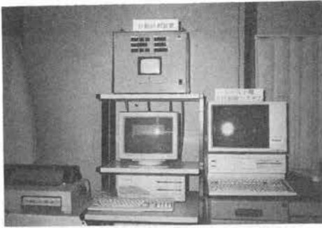
写真-11 中央監視室情報処理部状況
