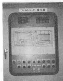
写真-35 グラフィック操作盤
