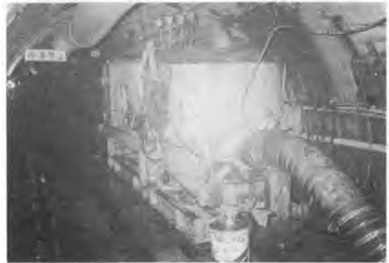
写真-3 No. 3 ポンプ
