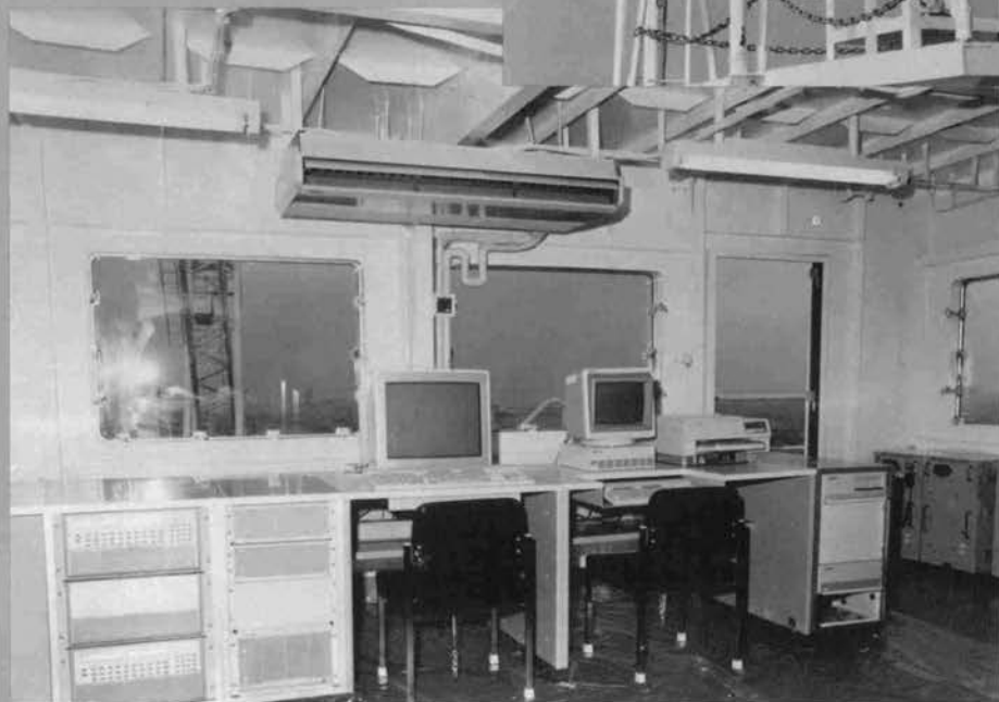
⇨監視室内作業管理システム
