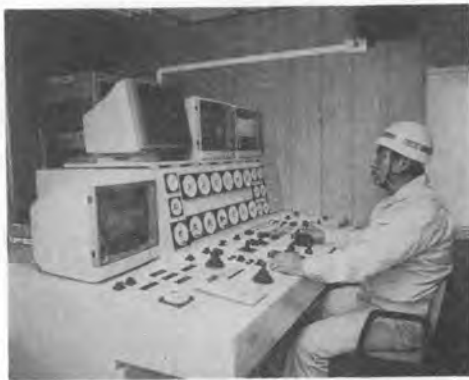
写真-2 遠隔操作盤
