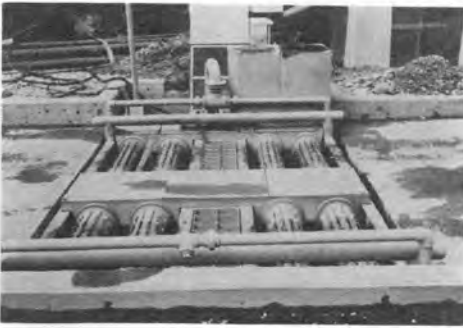
写真-3 ダンプ洗車設備
