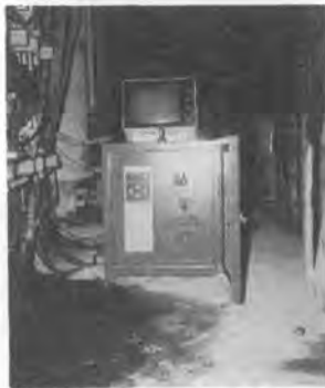
写真-4 ターゲット装置用の制御部とモニター
