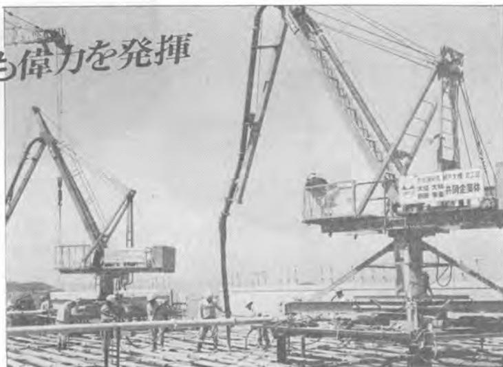
(本四架橋現場設置例)
