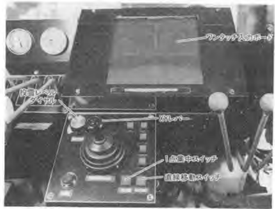
写真-1 投雪の制御パネル
