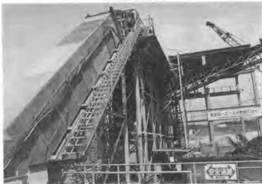
写真-4 インクラインド・コンベヤ傾斜部
