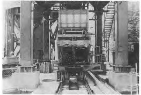
写真-3 トランスファーカー正面
