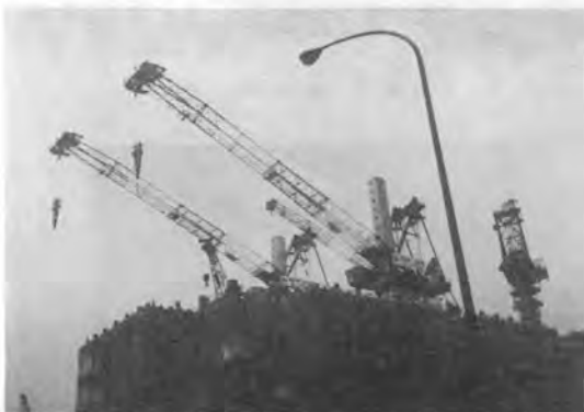
写真-13 総合監視装置により運転コントロールされているクライミングクレーン
