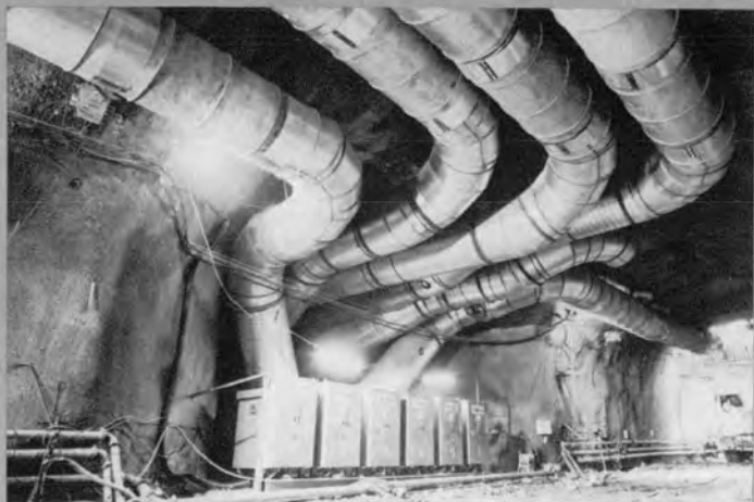
⇨ 換気トンネル設備
