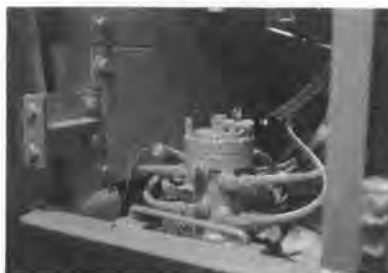
写真-3 マルチコントロールバルブ
