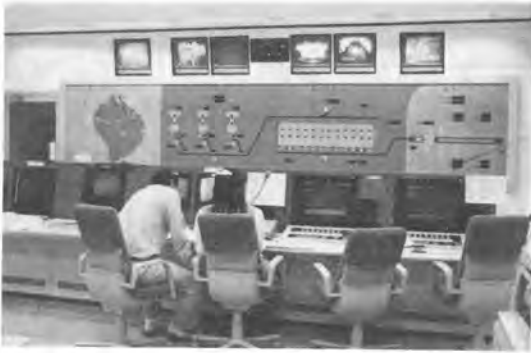
写真-2 中央監視室（土砂採取総合管理システム）
