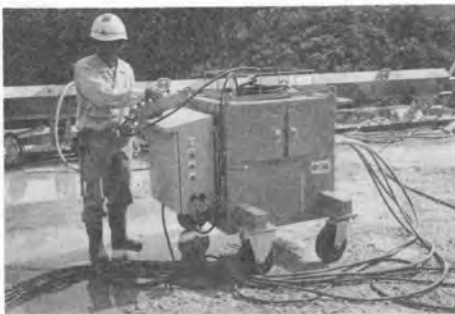
写真-6 油圧パワーユニット
