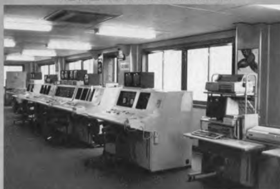
CP台船「海神」中央操作室 ⇨ 運転監視盤および自動記録装置
