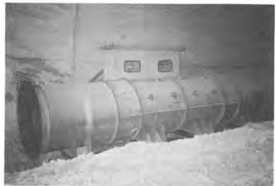
写真-3 コントラファン
