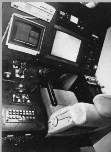
⇨底面清掃ユニット操作卓
