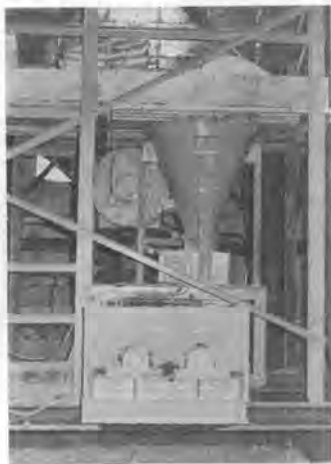
写真-2 固化プラント装置
