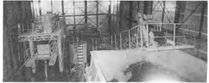
写真-4 泥水処理プラント
