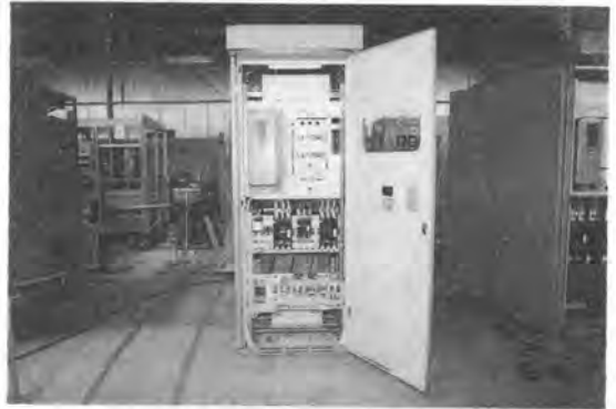
写真-50 125 kVA 型受変電キュービクル
