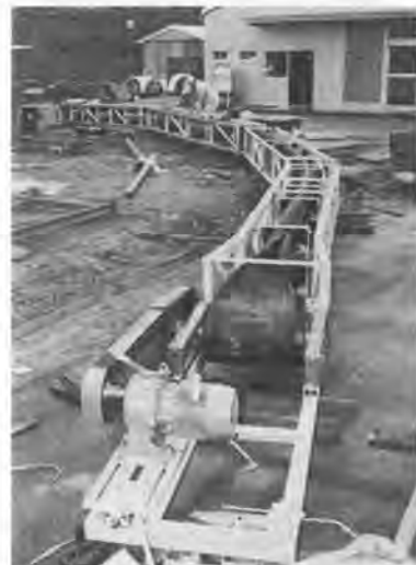
写真-1 パイプコンベヤ (ES コンベヤ)
