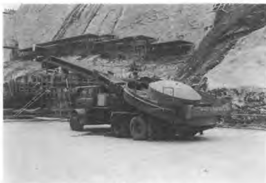
写真-2 RCD 用中継コンベヤ
