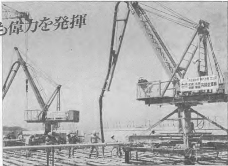
(本四架橋現場設置例)
