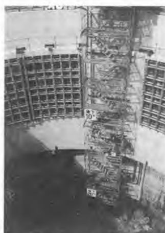
写真-2 直径 28 m の立坑構築状況 (6月末 28 m まで掘削。上部には組立のままの型枠が見られる)
