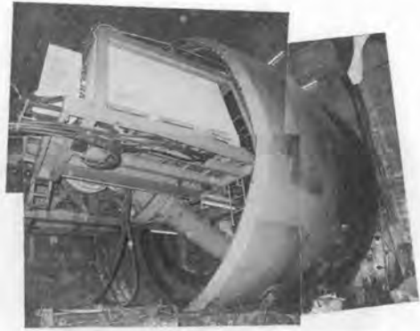
写真-5 シールドマシン（練馬第二工区）
