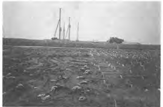
写真-2 地盤改良工事（右・ペーパードレーン、左・バックドレーン）
