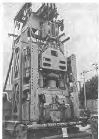
写真-1 BW ロングウォールドリル (下端部にローラカッタを張出している。幅 4 m, 厚 1.2 m, 深 98 m の地下連続壁の掘削機)
