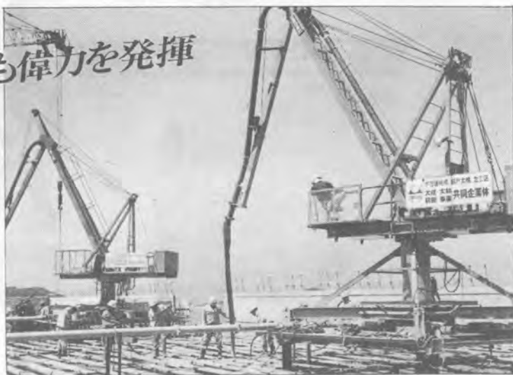
(本四架橋現場設置例)
