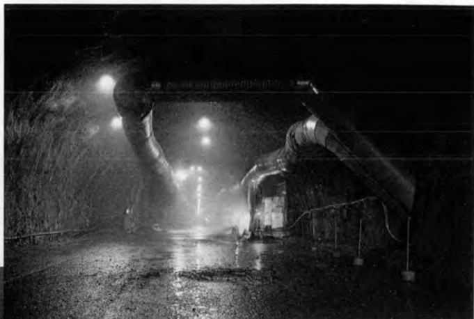
⇨坑導換気設備
