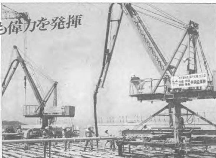
(本四架橋現場設置例)
