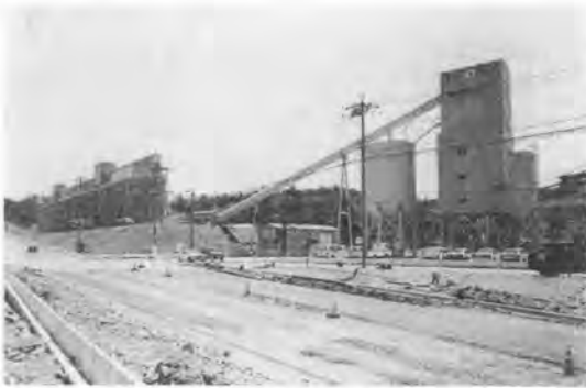
写真-1 原子力発電所建設向のコンクリートプラント
