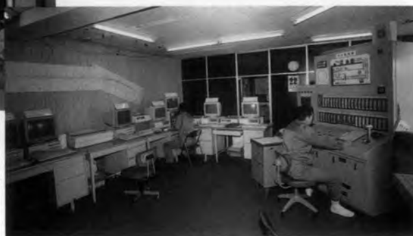
シールド施工管理室⇨
