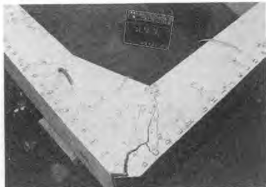
写真一 函断面載荷実験供試体 No. ① のひびわれ状況 (試験後)
