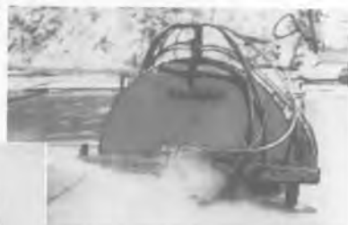
ダムレータンスカット Dam Lattance Remover
