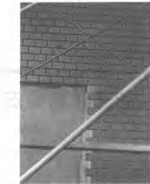
写真-9 現場におけるロボットと職人によるタイル施工面
