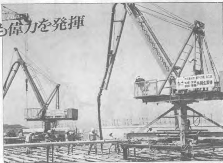
(本四架橋現場設置例)
