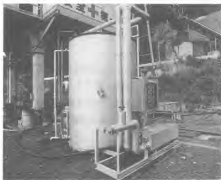
写真-1 冷水製造装置本体
