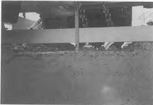
写真-4 切削表面の状況
