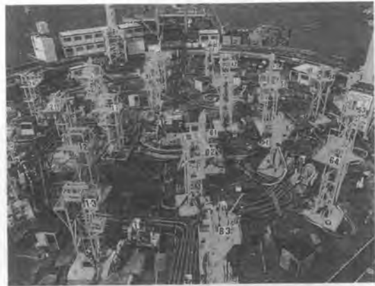
写真-2 ケーソン上の打設設備（φ200のコンクリート配管、および分岐弁と24台の打設管引揚装置など）
