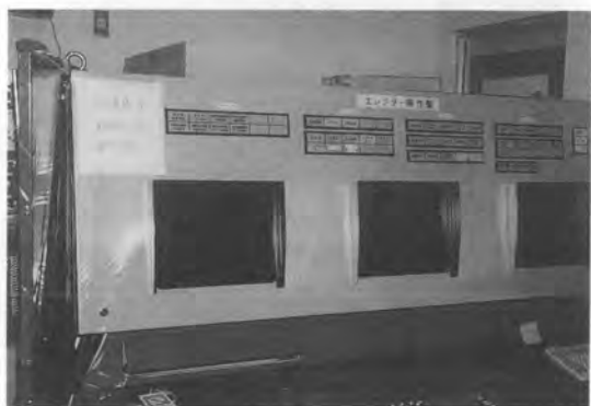
写真-5 セグメント組立操作盤
