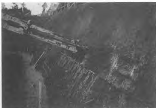
写真-18 NJD 工法によるせん孔状況 孔よりスライムが流出している
