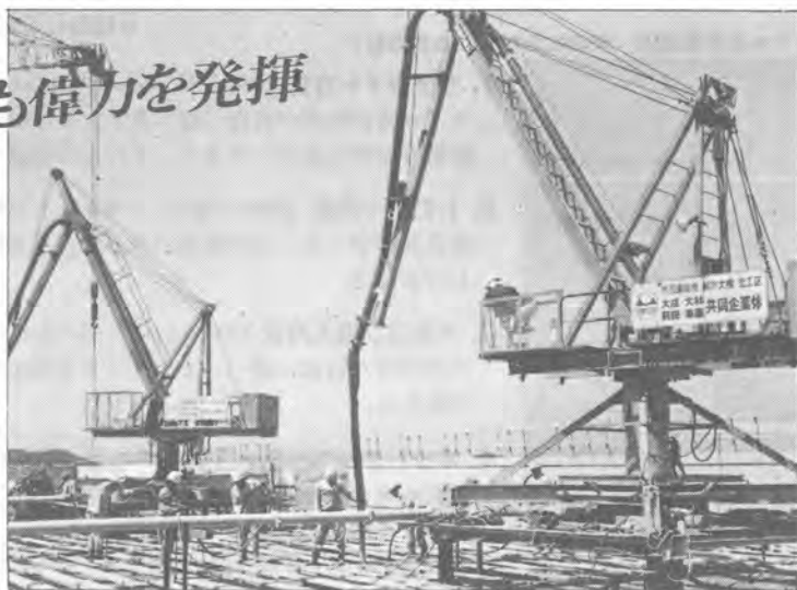
(本四架橋現場設置例)
