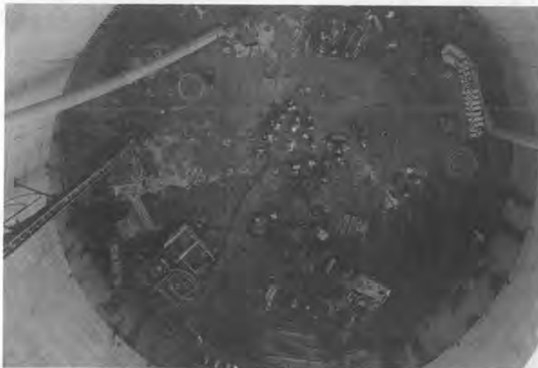
写真-1 梅里公園内立坑における 98 m 連壁先端部地盤改良工事作業状況 地下 34 m 施工基盤
