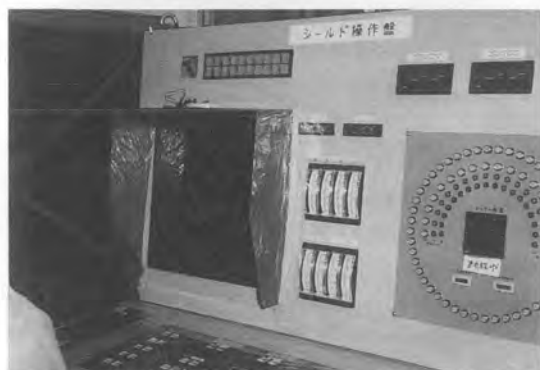
写真-4 シールド操作盤 (すべて遠隔操作)
