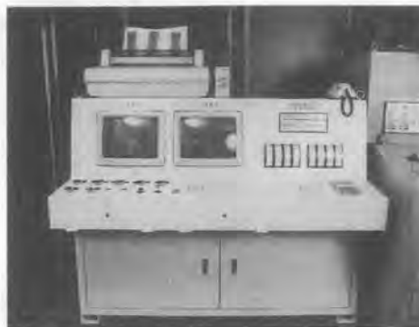
写真一29 制御システム
