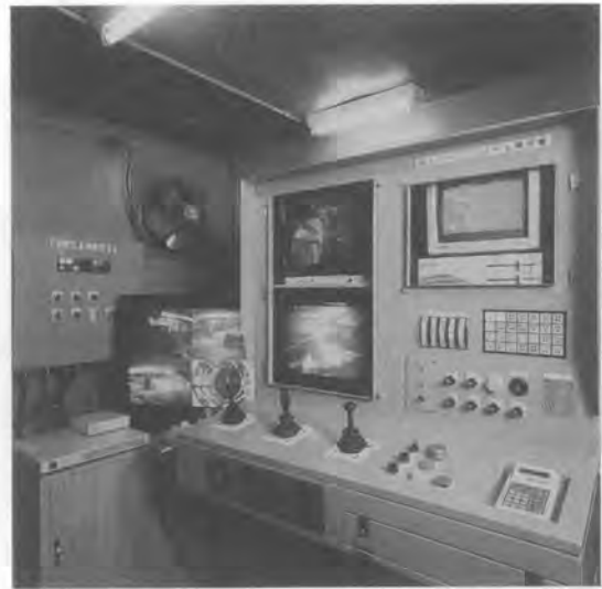
写真-1 中央管理室内遠隔操作盤
