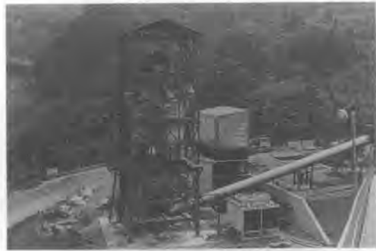
写真-36 骨材・真空冷却設備
