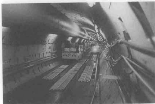
写真-9 無人搬送車 ポイント離合状況
