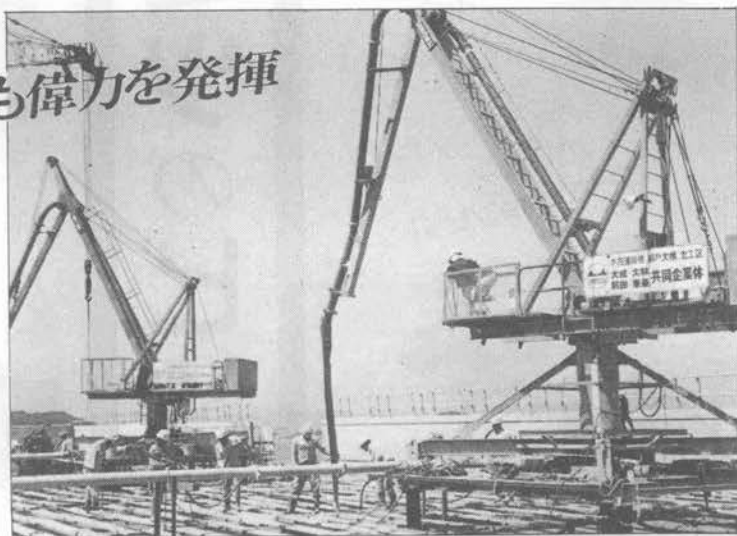
(本四架橋現場設置例)
