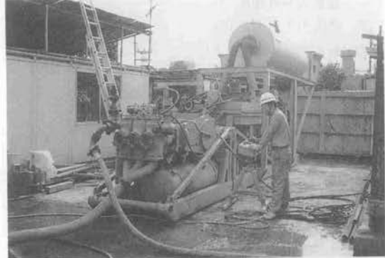
写真-4 高圧ポンプ
