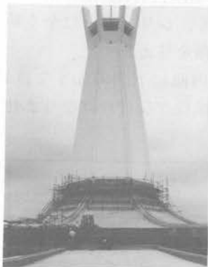
沖縄平和祈念堂の塩害、 劣化損傷及洩水の防止
