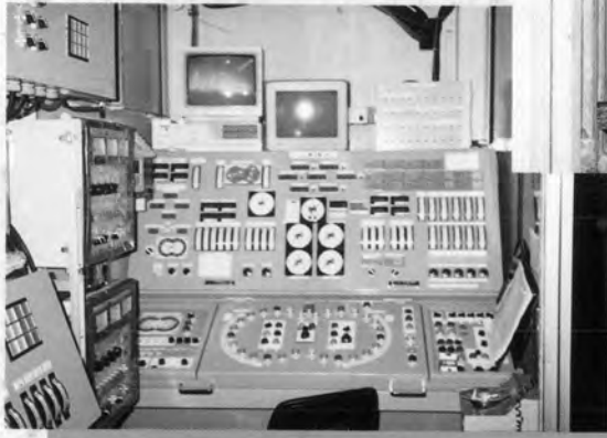
⇨シールド機の運転室内
