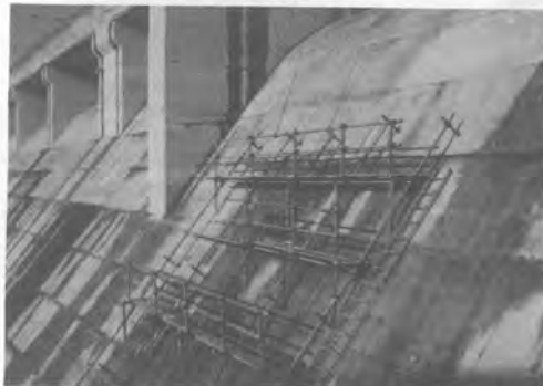
ダムの水漏れ状況
