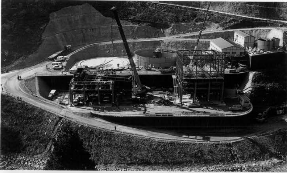
⇨ 骨材プラント濁水 処理設備
