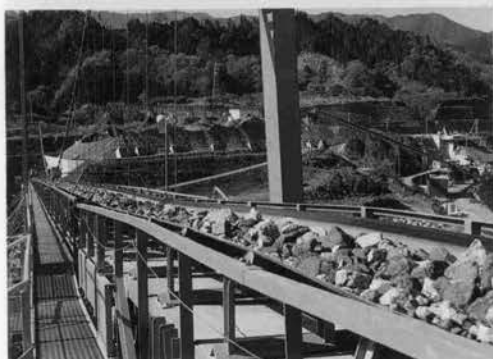
⇨骨材生産設備 (一次破碎設備→サージ パイル→ベルコン橋→(洗浄設備へ))
