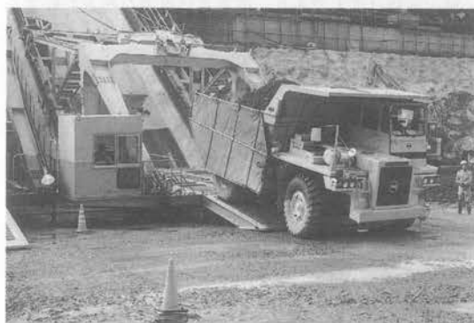
写真二 インクラインから堤体上へ降りる20tダンプトラック
