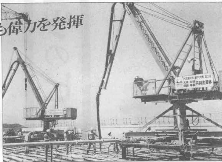
(本四架橋現場設置例)
