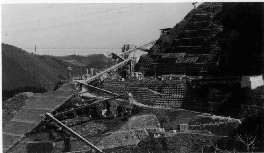
⇨ダムサイト右岸 (コンクリート 生産設備)
