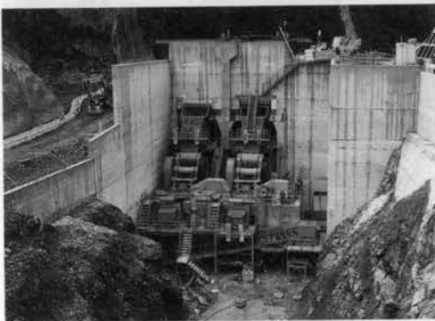
⇨一次破碎設備
